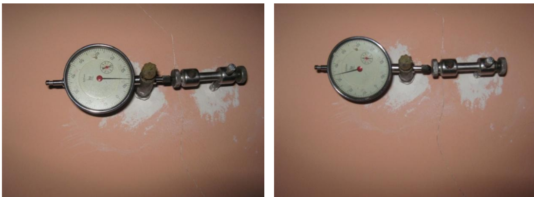
სურ. 3.1. ქ. თბილისში ძმები ზუბალაშვილების ქ. №23-ში მდებარე შენობის (შპს „ალანია“-ს კუთვნილი) კედელზე არსებული ბზარის განვითარებაზე დაკვირვებისათვის „შუქურის“ განთავსების მაგალითი
